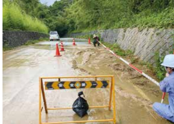
▶ 流出した土砂(東部縦幹線・峰)
