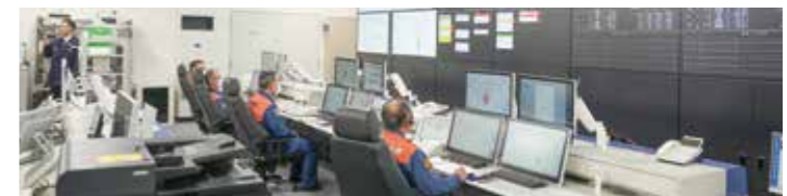
▲田川地区・中間市消防指令センター指令室
