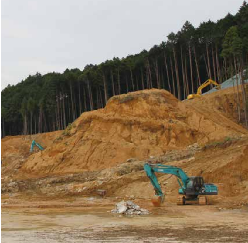
▲9月15日現在、大任町で、し尿じん芥処理施設建設用の土地を造成している様子(成光)
