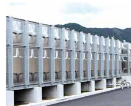
④配水池(配水施設) 消毒され、きれいになった水は配水池に貯められます。(ステンレス製水槽2池で約500t分)
