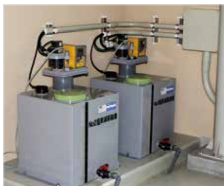
③浄水池(送水・減菌施設) ろ過された水である浄水を貯め、ろ過地から流れてくる水量に応じて、次亜塩素酸ナトリウムを注入し、消毒を行います。
