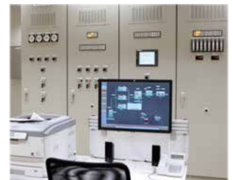
⑤管理棟(管理・制御施設) 流量・水質を管理し、配水管を通して一般家庭や店舗、工場などへの配水を行う重要な施設です。
