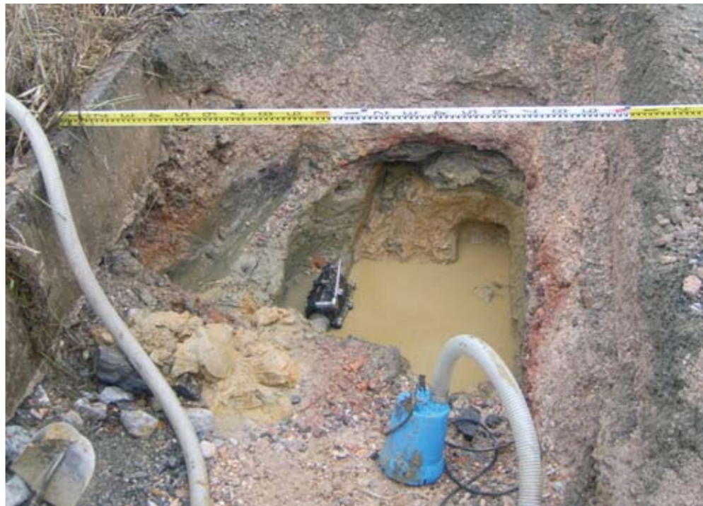
▲10月17日に桑原工業団地付近で水道管破裂が発生した現場
