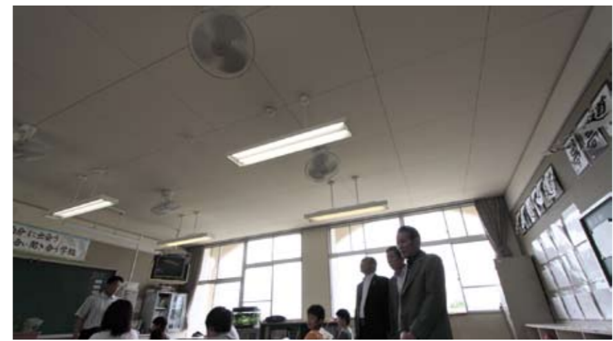
▲田川市郡では一番早く、扇風機を設置し環境改善を行いました
