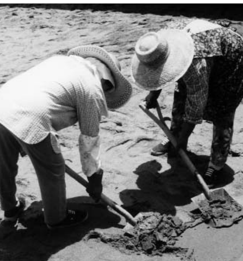
▲ ろ過池の表面に不純物が溜まると、浄化機能が低下するので、定期的に取り除く
