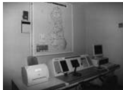
▲ 防災無線放送室
